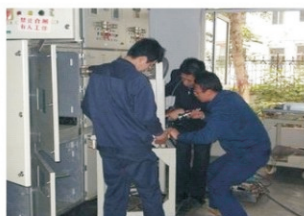
变配电设备运行与维护实训室
